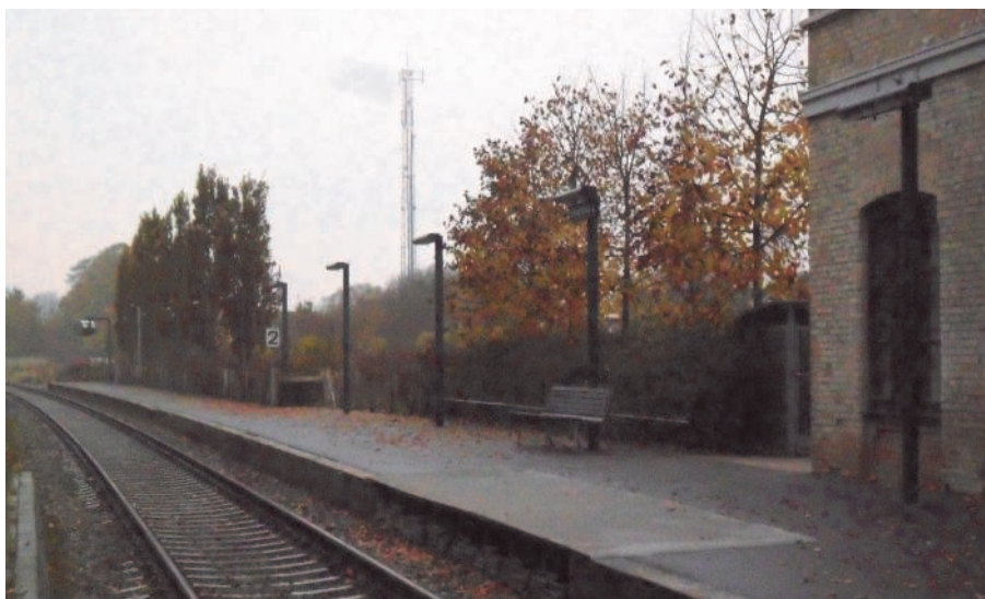
Kværndrup Station, med den midlertidige lappeløsning af den faldefærdige perron.
